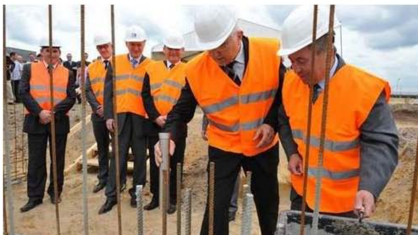
Tuby zostały przykryte betonem, dzięki czemu na zawsze pozostaną w fundamentach zakładu (fot. Tomasz Gawalkiewicz)
